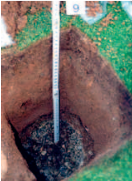
Foto 1: Wassereinstau aus der Dränschicht (Foto: Armbruster).
